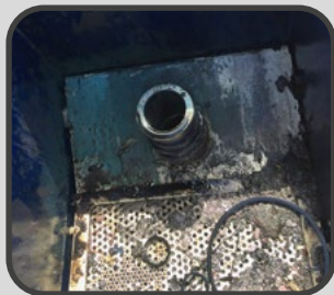
Entonnoir de remplissage et tuyau de soutirage
